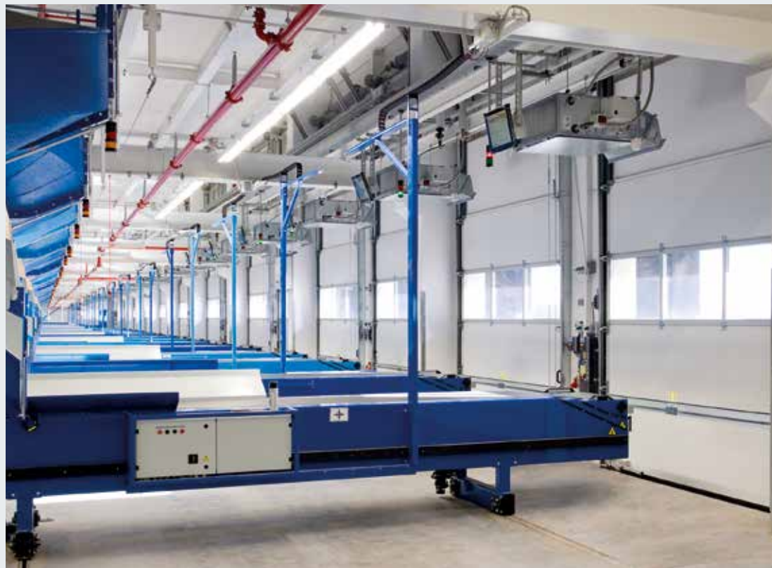
Das teilbare Industrietor wurde speziell für Logistikzentren z. B. von Paketdiensten entwickelt.
